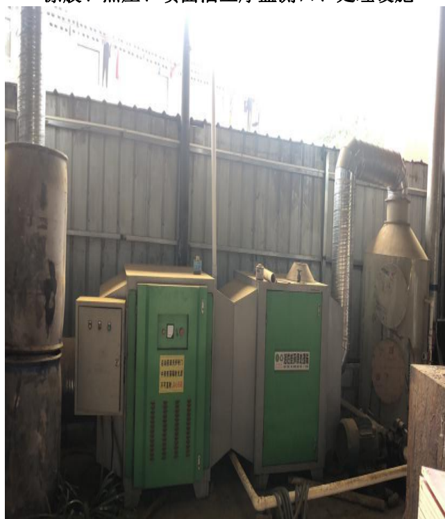
反应釜废气处理设施
