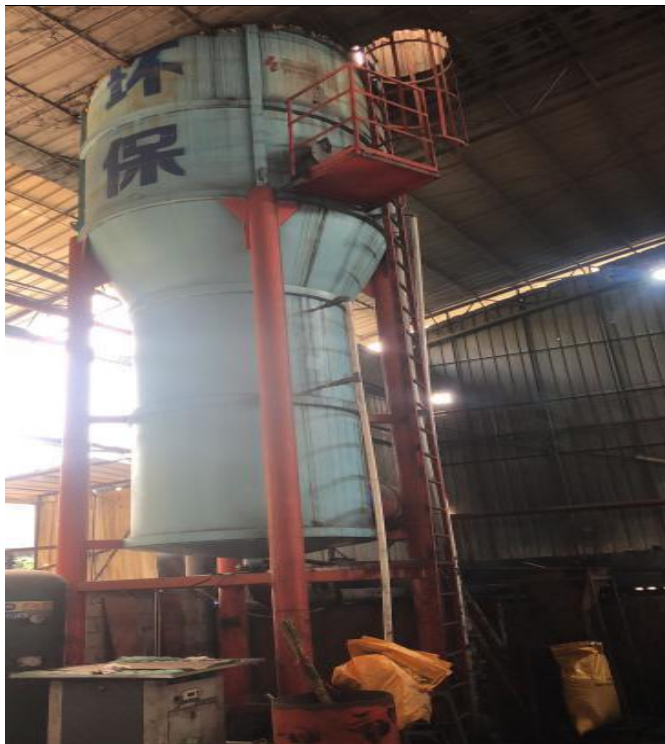
锅炉废气排放口
